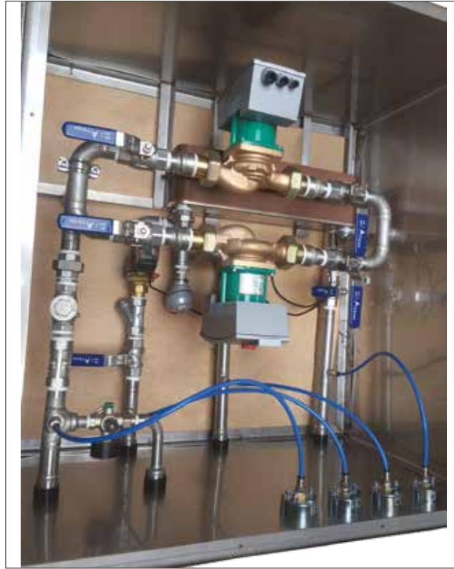
Chiller ile üniteler arasında devre ayırma cihazıdır.
